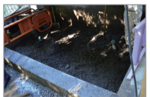
濾過槽の中には細かい砂利が敷き詰められている
